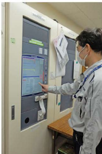
防災センターでの警報盤の点検
