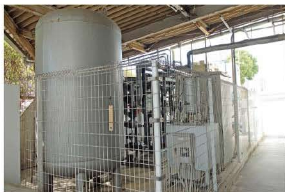
地下水浄化装置
