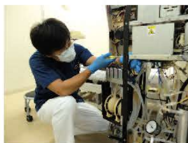
透析装置の内部の定期点検を行っています
